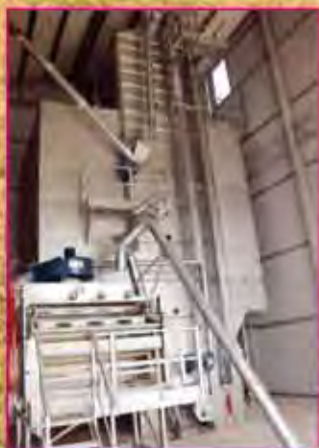
IMPIANTO ESSICCAZIONE 4 RR 6/4 BPN DA 45 TON
