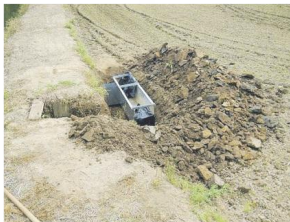
Installazione di un misuratore del flusso idrico all'uscita dell'acqua di una camera
